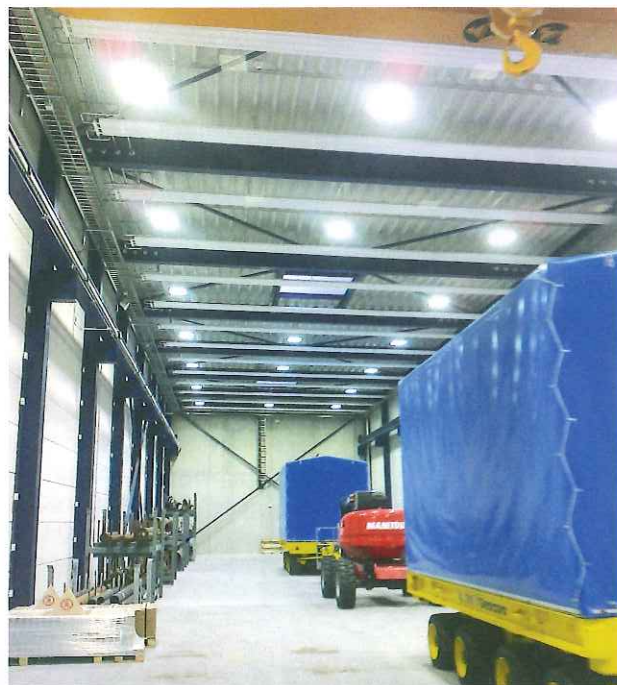
ULL-ST120 LED Leuchten von Unitron beleuchten die 9 m hohe Service-Halle des KKW Gösgen. Oben: Giebelbeleuchtung im Schösschen Biberist. (Bilder: Unitron)
